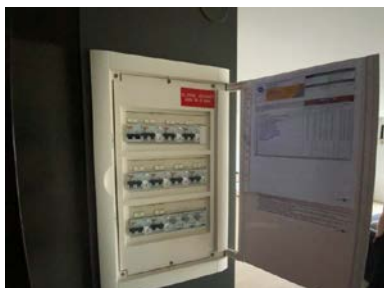
El-skap med automatsikringer.
