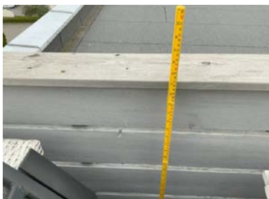
Rekkverket er for lavt i forhold til dagens krav.
