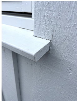
Vannbrett uten beslag. Omramning ned mot vannbrett.
