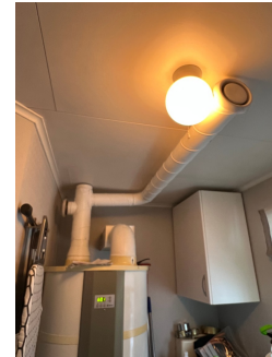
Genvex varmepumpeanlegg m/ventilasjon
