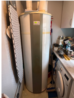
Genvex varmepumpeanlegg m/ventilasjon
