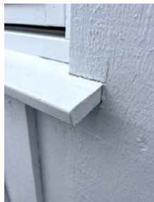
Vannbrett uten beslag. Omramning ned mot vannbrett.
