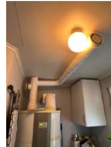
Genvex varmepumpeanlegg m/ventilasjon
