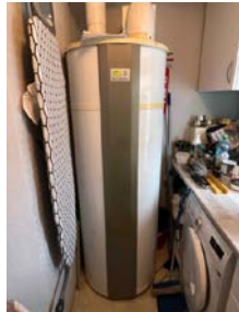
Genvex varmepumpeanlegg m/ventilasjon
