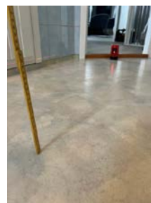
Gulv høyere midt på - en høyde ved gulv/dør.
