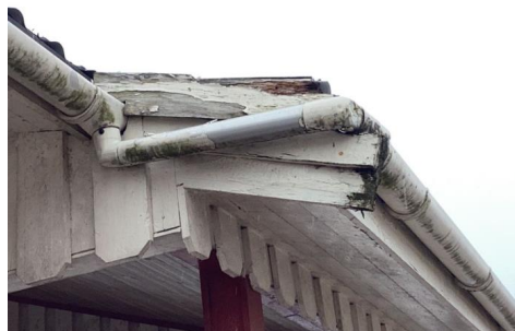
Eksempel på utvendig slitasje.
