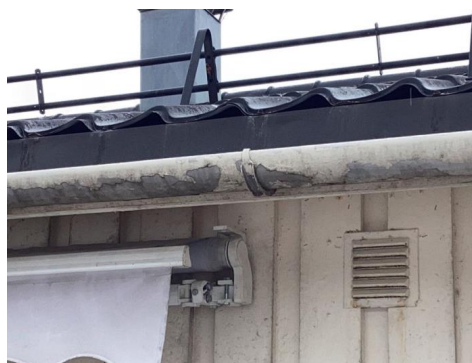
Eksempel på slitasje.
