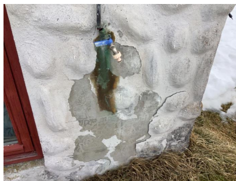
Eksempel på avskaling på grunnmuren.
