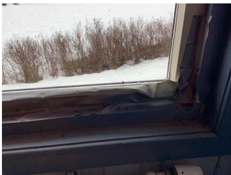
Et vindu er tapet igjen på innsiden.
