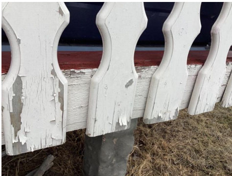
Eksempel på slitasje.
