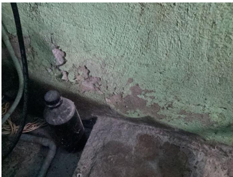
Eksempel på avskaling på murvegger.
