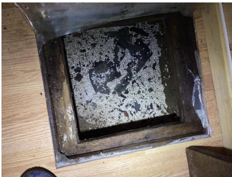
Råteskade i gulv ved luke.
