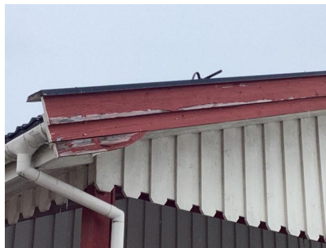
Eksempel på utvendig slitasje.
