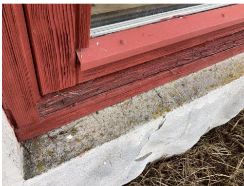
Eksempel på slitasje.
