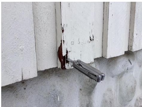
Eksempel på råteskade.
