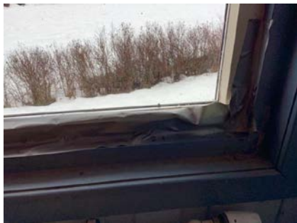
Et vindu er tapet igjen på innsiden.
