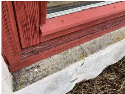
Eksempel på slitasje.
