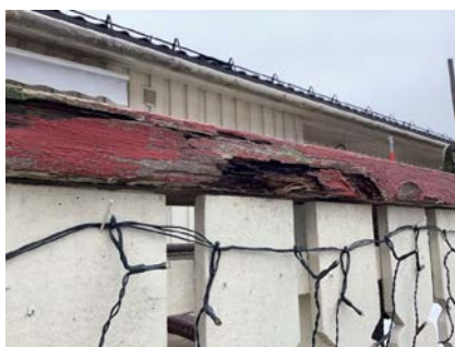
Eksempel på råte i toppbord.
