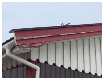
Eksempel på utvendig slitasje.
