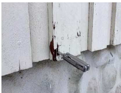
Eksempel på råteskade.
