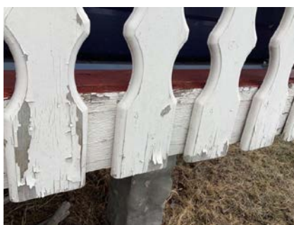
Eksempel på slitasje.
