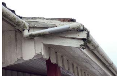
Eksempel på utvendig slitasje.
