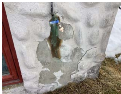
Eksempel på avskaling på grunnmuren.
