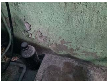
Eksempel på avskaling på murvegger.
