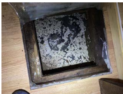
Råteskade i gulv ved luke.
