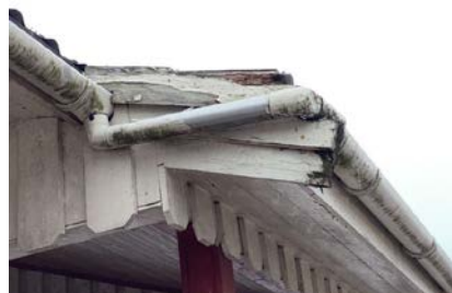
Eksempel på utvendig slitasje.
