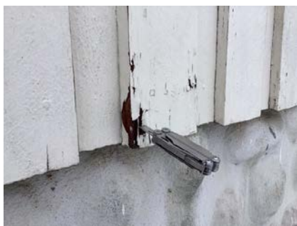
Eksempel på råteskade.
