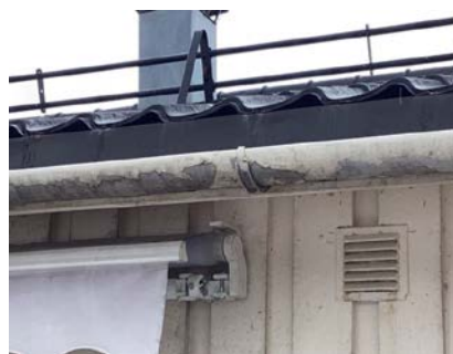
Eksempel på slitasje.
