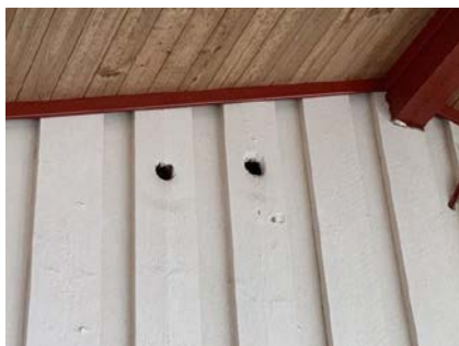
Eksempel på skade etter hakkespett.
