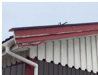
Eksempel på utvendig slitasje.
