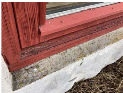
Eksempel på slitasje.
