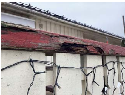
Eksempel på råte i toppbord.
