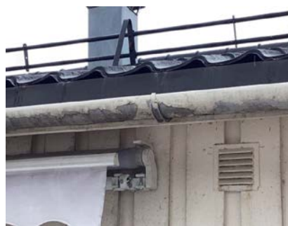
Eksempel på slitasje.
