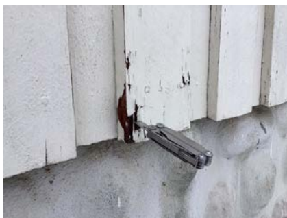
Eksempel på råteskade.
