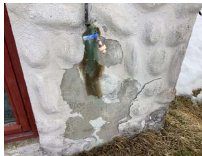
Eksempel på avskaling på grunnmuren.
