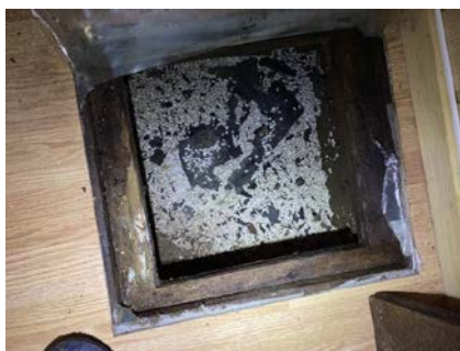
Råteskade i gulv ved luke.
