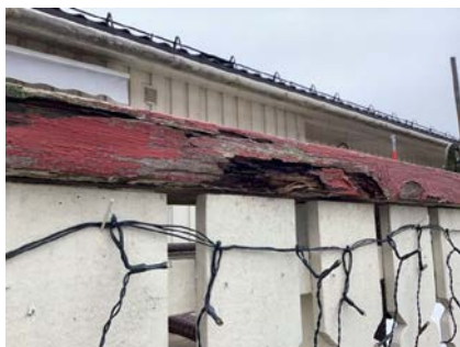
Eksempel på råte i toppbord.
