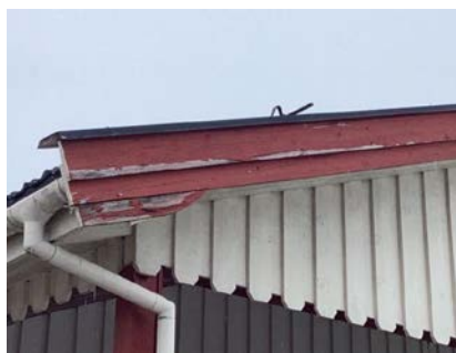
Eksempel på utvendig slitasje.
