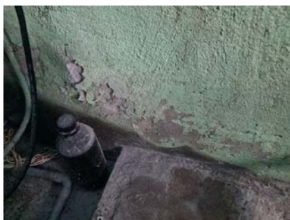
Eksempel på avskaling på murvegger.
