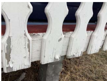
Eksempel på slitasje.
