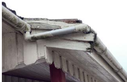
Eksempel på utvendig slitasje.
