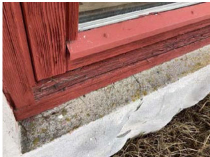
Eksempel på slitasje.
