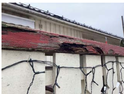
Eksempel på råte i toppbord.
