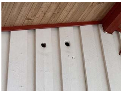
Eksempel på skade etter hakkespett.
