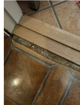
Mangelfull avslutning på belegg ved terskel
