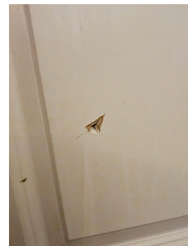
Enkelte sår/hakk på innerdører
