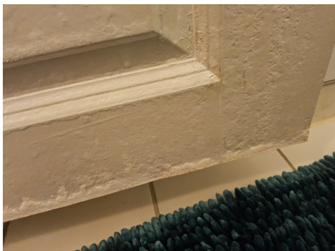
Fuktskade på dør til bad.
