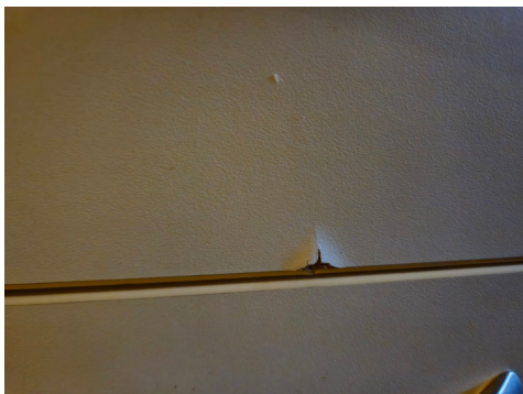
Skader på kjøkkenfronter
