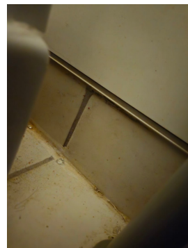
Ingen fuge i nedre kant av baderomsplater.
