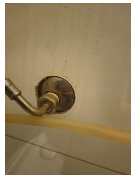
Ikke fagmessig utførelse ved rørgjennomføringer.
