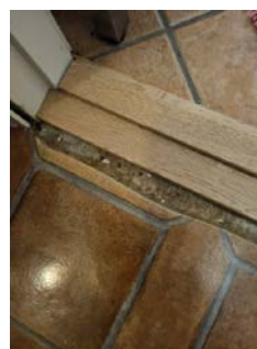
Mangelfull avslutning på belegg ved terskel
