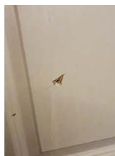
Enkelte sår/hakk på innerdører
