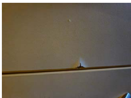
Skader på kjøkkenfronter
