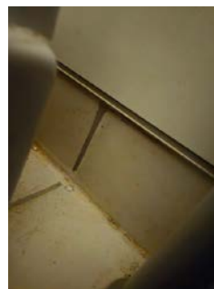
Ingen fuge i nedre kant av baderomsplater.
