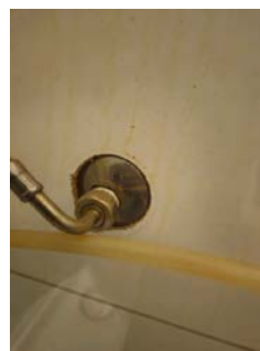
Ikke fagmessig utførelse ved rørgjennomføringer.
