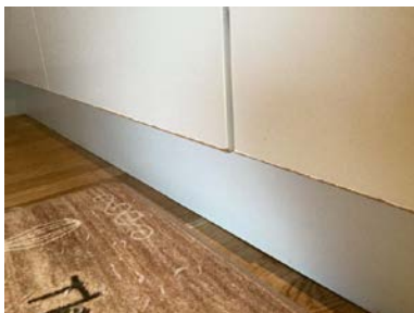
Slitasjeskade på skapdører.
