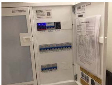
Sikringsskap på teknisk rom.
