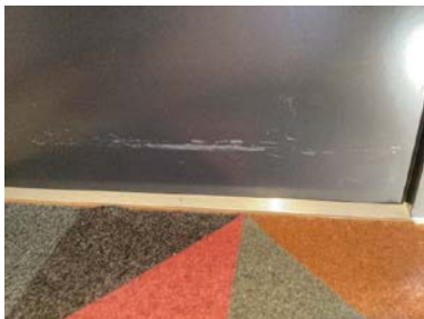
Slitasjeskade på ytterdør.
