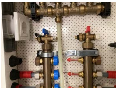
Stoppekran i rørskap på bad.
