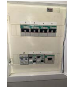
Sikringsskap med automatsikringer.
