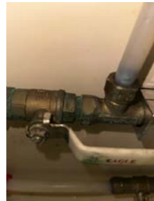
Stoppekran på bad, irr på kobberrør
