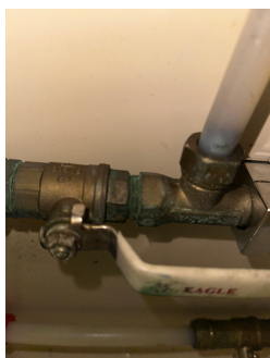
Stoppekran på bad, irr på kobberrør
