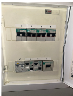
Sikringsskap med automatsikringer.
