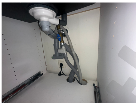
Røropplegg i kjøkkenbenk
