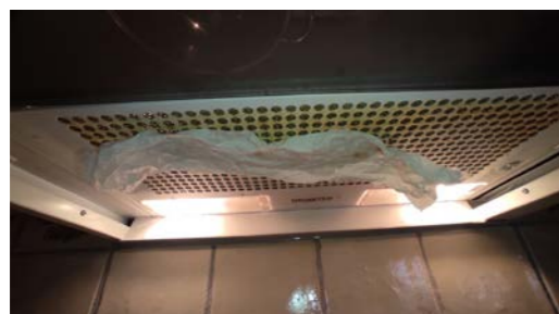
Test av avtrekket
