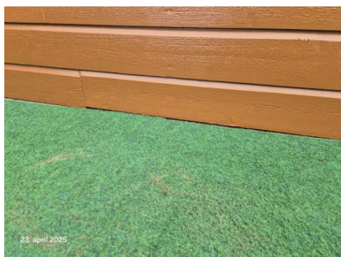
Kledningsbord som mangler lufting.
