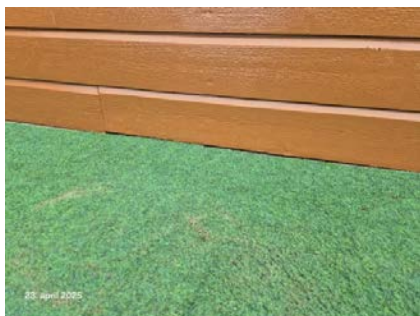
Kledningsbord som mangler lufting.
