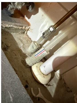
Bildet viser at det mangler tettemuffer i enden av varerør på rør-i-rør-system.
