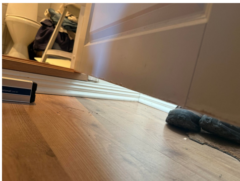
Bildet viser skade/svelling nederst på dørbildet til badet i 1.
