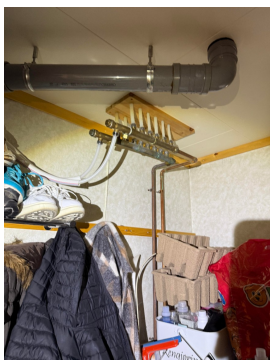
Bildet viser samlingspunkt for rør i rør på vaskerommet.
