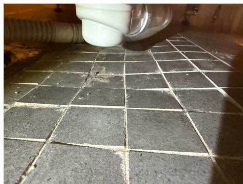
Bildet viser ujevnheter i gulvfliser.
