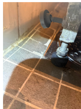
Bildet viser kosmetisk avskalling på fliser.
