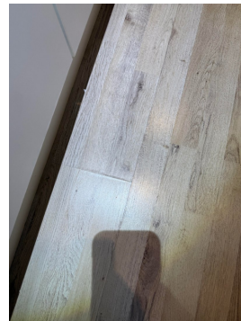
Bildet viser laminatgulv med stedvis hevelse i skjøter.
