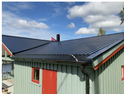
Tettelst i ned kant av plater er løsnet
