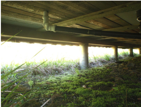
Avløp fra dusjkabinett/ servant er plugget
