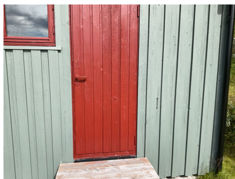
Dør og karm er værslitt og har tørkesprekker og råteskade.
