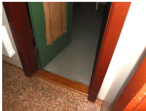
Løst belegg på soverom
