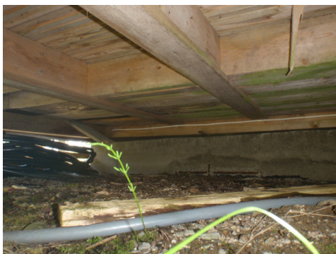
Skade på betongdrager, synlig rustangrepet armering
