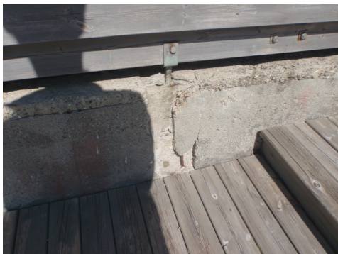
Skade på ringmur, synlig rustanrepet armering.
