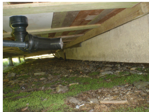
Avløp er frakoblet og tettet.
