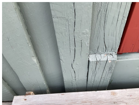
Partielle tørkesprekker og råteskader på utvendig kledning.
