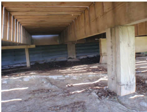
Svak og noe provisorisk innfesting og understøttelse av balkong
