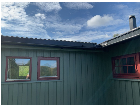
Provisorisk tetting av skjøt, Takfotbedlag er ikke ført ned i takrenne
