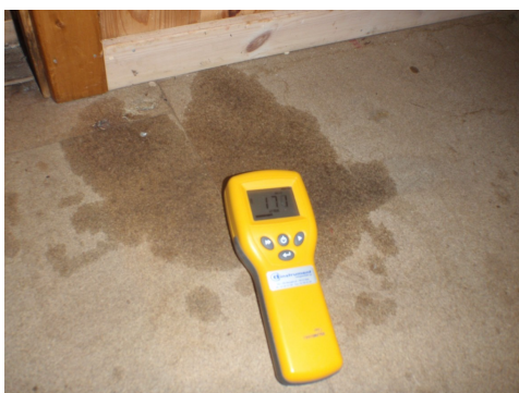
Kun sponplater på gulv i gang/bi-inngang. Søl etter olje/ukjent veske.
