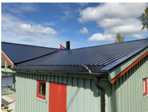
Noe nedbøying av tak på tilbygg.
