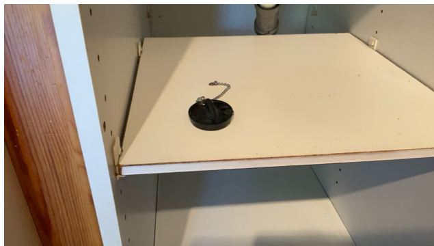
Fuktskader/utsvelling på hyller
