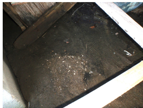
Synlig tegn på at det er oppdemming av vann i kryperommet. Råteskader på treverk
