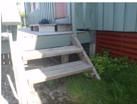
Mangler rekkverk på en side og stusstrinn
