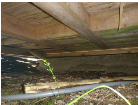
Deler av gulv i tilbygg ved bi-inngang i sørøstlig hjørne av tilbygget er uisolert
