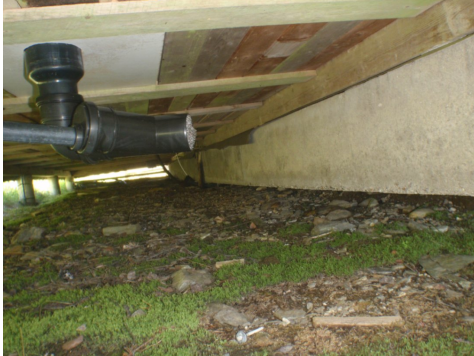
Avløp fra sluk fra rom med dusjkabinett, er plugget
