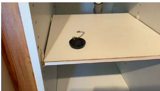
Fuktskader/utsvelling på hyller
