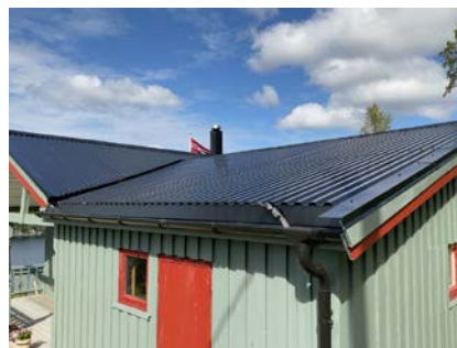
Tettelist i ned kant av plater er løsnet
