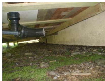
Avløp er frakoblet og tettet.
