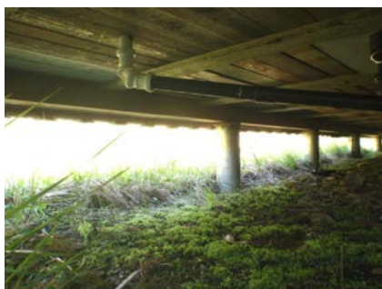
Avløp fra dusjkabinett/ servant er plugget
