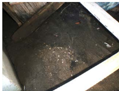
Synlig tegn på at det er oppdemming av vann i kryperommet. Råteskader på treverk
