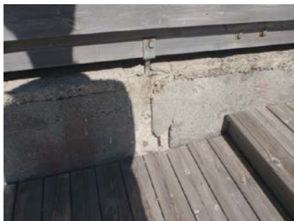
Skade på ringmur, synlig rustanrepet armering.
