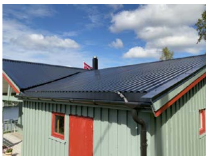
Noe nedbøying av tak på tilbygg.
