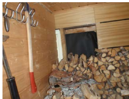
Manglende ferdigstillelse av overflater.
