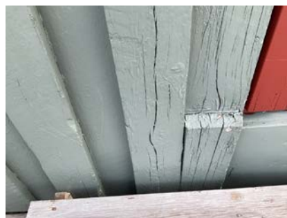
Partielle tørkesprekker og råteskader på utvendig kledning.
