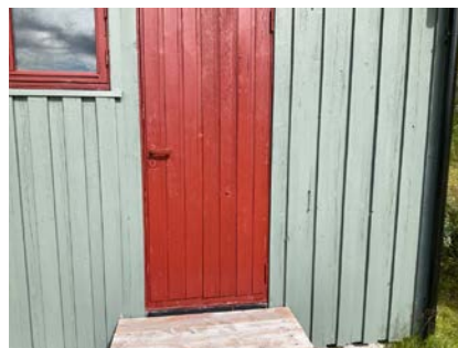
Dør og karm er værslitt og har tørkesprekker og råteskade.
