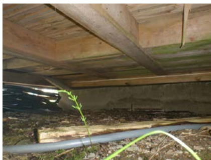
Deler av gulv i tilbygg ved bi-inngang i sørøstlig hjørne av tilbygget er uisolert
