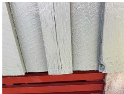
Partielle tørkesprekker og råteskader på utvendig kledning.
