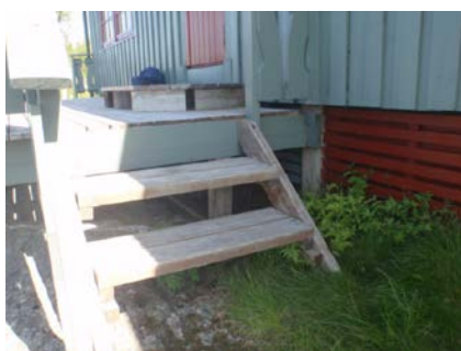
Mangler rekkverk på en side og stusstrinn
