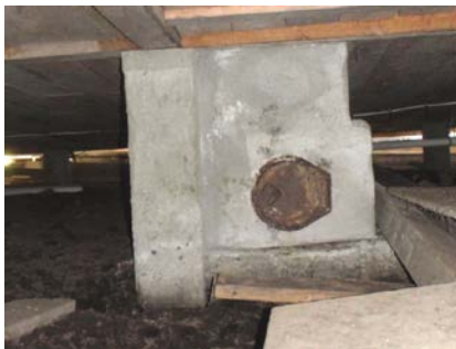
Løst trevirke i nærhet av sotluke må fjernes
