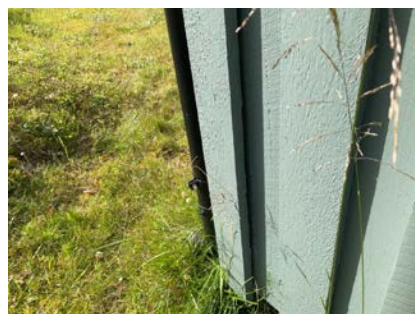
Løsnet stående trekledning.
