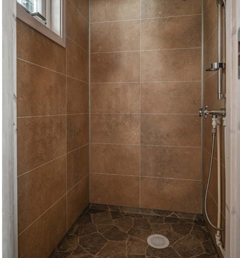
Dusjrom med våtromsbelegg på gulv og våtromsplater på vegger. Vann fra vandunk via gassvannvarmer.
