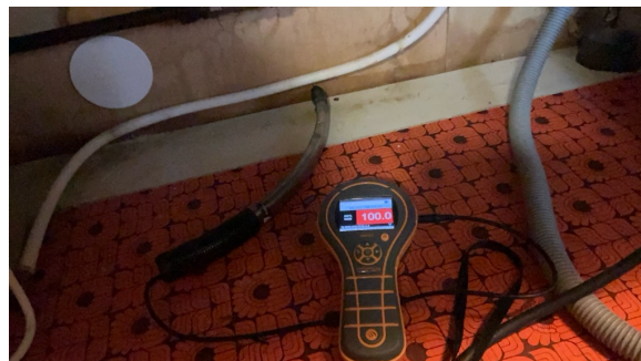
Fukt i vegg registrert etter måling som følge av lekkasje fra oppvaskmaskinslange.
