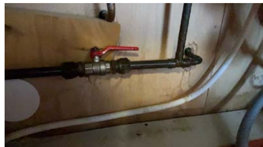
Kondens på vannledning
