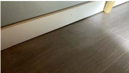
Åpning under gulvlist
