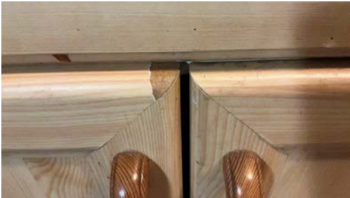
Overflateskade på skapdør
