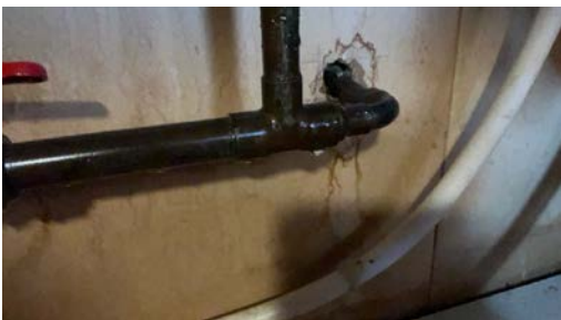
Kondens på vannledning
