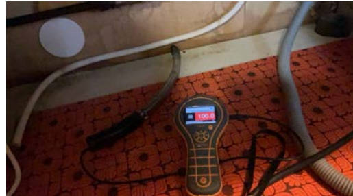
Fukt i vegg registrert etter måling som følge av lekkasje fra oppvaskmaskinslange.
