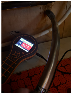
Fukt registrert under vannrør 13.03.2026
