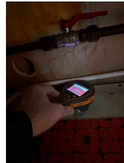
Indikasjoner på fukt ved fuktsøk under vannrør 13.03.2026.
