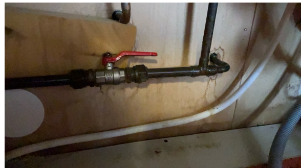
Kondens på vannledning
