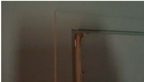
Registrert overflateslitasje, samt at dørbladet tar i karm
