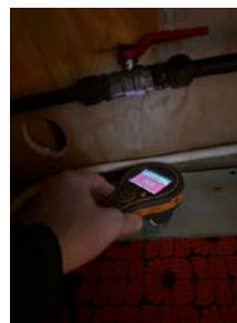
Indikasjoner på fukt ved fuktsøk under vannrør 13.03.2026.
