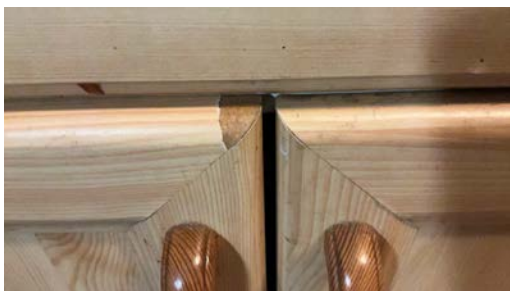
Overflateskade på skapdør
