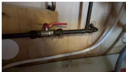
Kondens på vannledning
