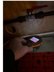
Indikasjoner på fukt ved fuktsøk under vannrør 13.03.2026.
