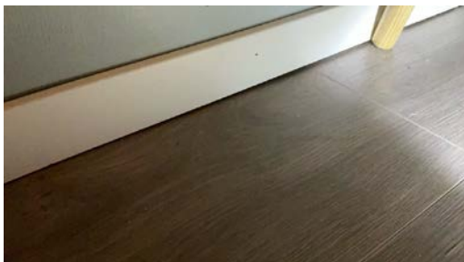
Åpning under gulvlist
