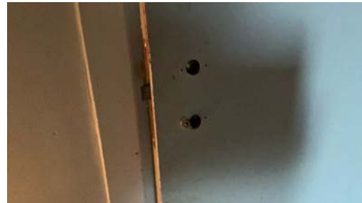
Manglende vridere og nøkkelskilt
