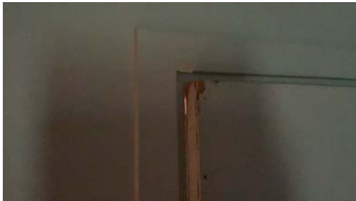
Registrert overflateslitasje, samt at dørbildet tar i karm
