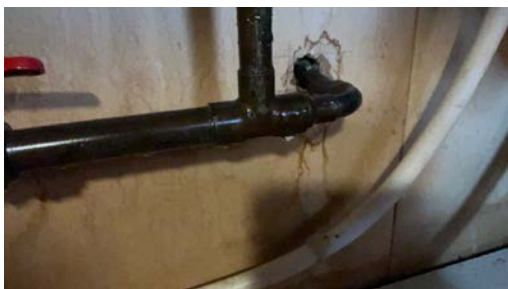
Kondens på vannledning
