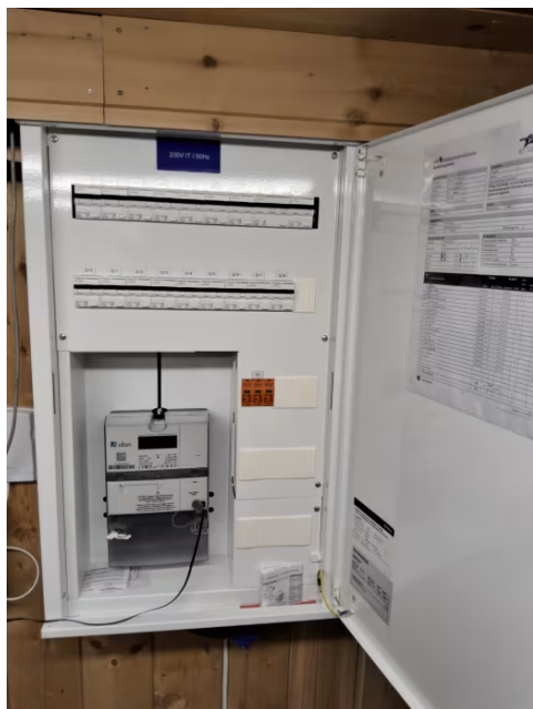
Sikringsskap er plassert i kjellerstue.
