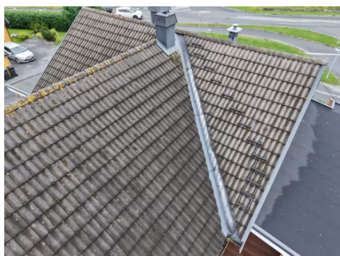
Det er etablert takstige til pipe.
