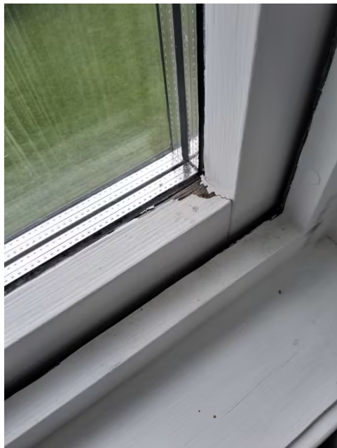
Symptomer etter kondens registreres på enkelte vinduer.
