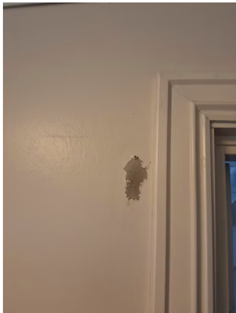
Slitasje på veggflater.
