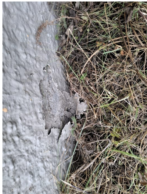
Stedvis malingsavskalling på grunnmuren.
