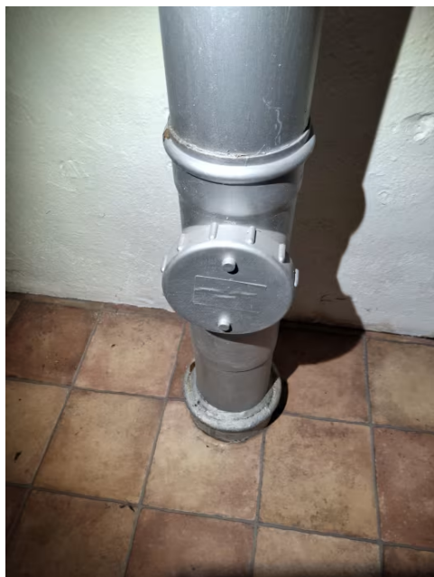
Stakeluke er plassert i bod i kjeller.
