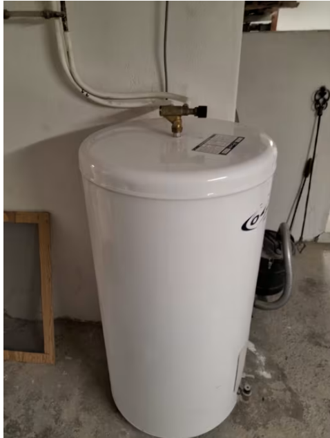
Varmtvannsbereder er plassert i kjelleretasje.
