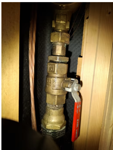
Det registreres kondens på rør ved hovedstoppekran.
