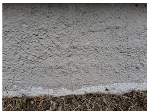
Det registreres enkelte riss i grunnmuren,
