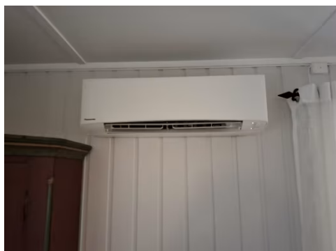
Varmepumpe er plassert i spisestue.
