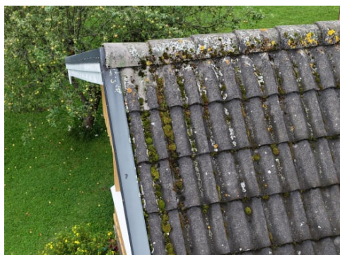
Det registreres mosevekst på taktekingen.
