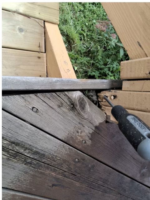
Det registreres stedvise råteskader i konstruksjonen.
