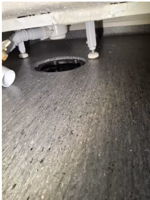
Sluk av eldre type under dusjkabinett.
