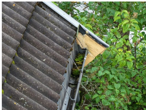
Stedvise oppsamlinger av mose i takrenner.
