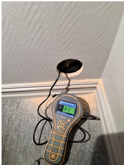
Bilde fra fuktmåling i veggkonstruksjon tilstøtende våtsone.
