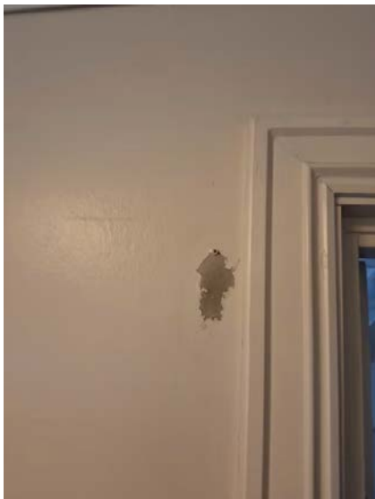
Slitasje på veggflater.
