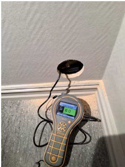
Bilde fra fuktmåling i veggkonstruksjon tilstøtende våtsone.
