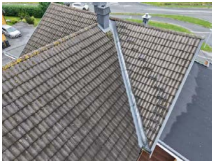
Det er etablert takstige til pipe.
