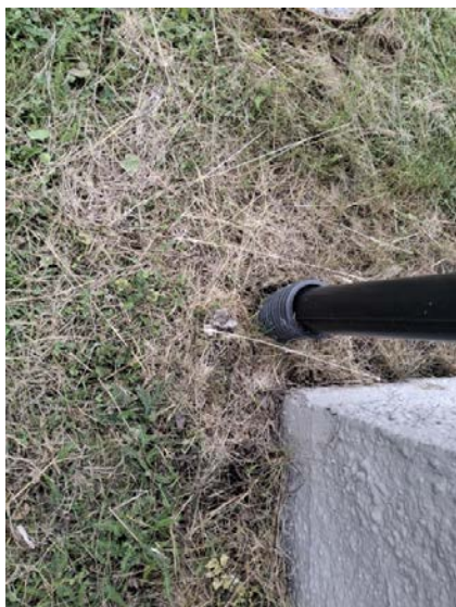
Taknedløp er avsluttet i drenerør.
