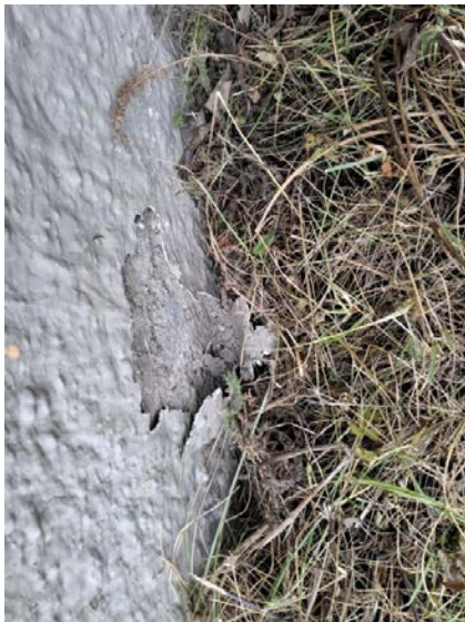
Stedvis malingsavskalling på grunnmuren.
