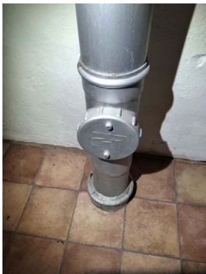
Stakeluke er plassert i bod i kjeller.
