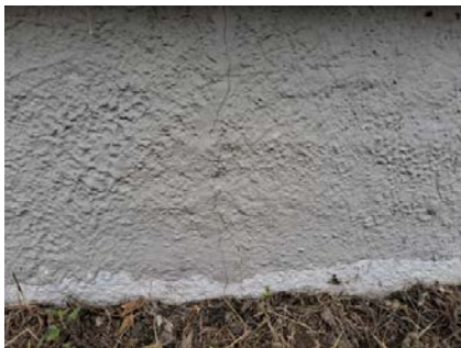
Det registreres enkelte riss i grunnmuren,
