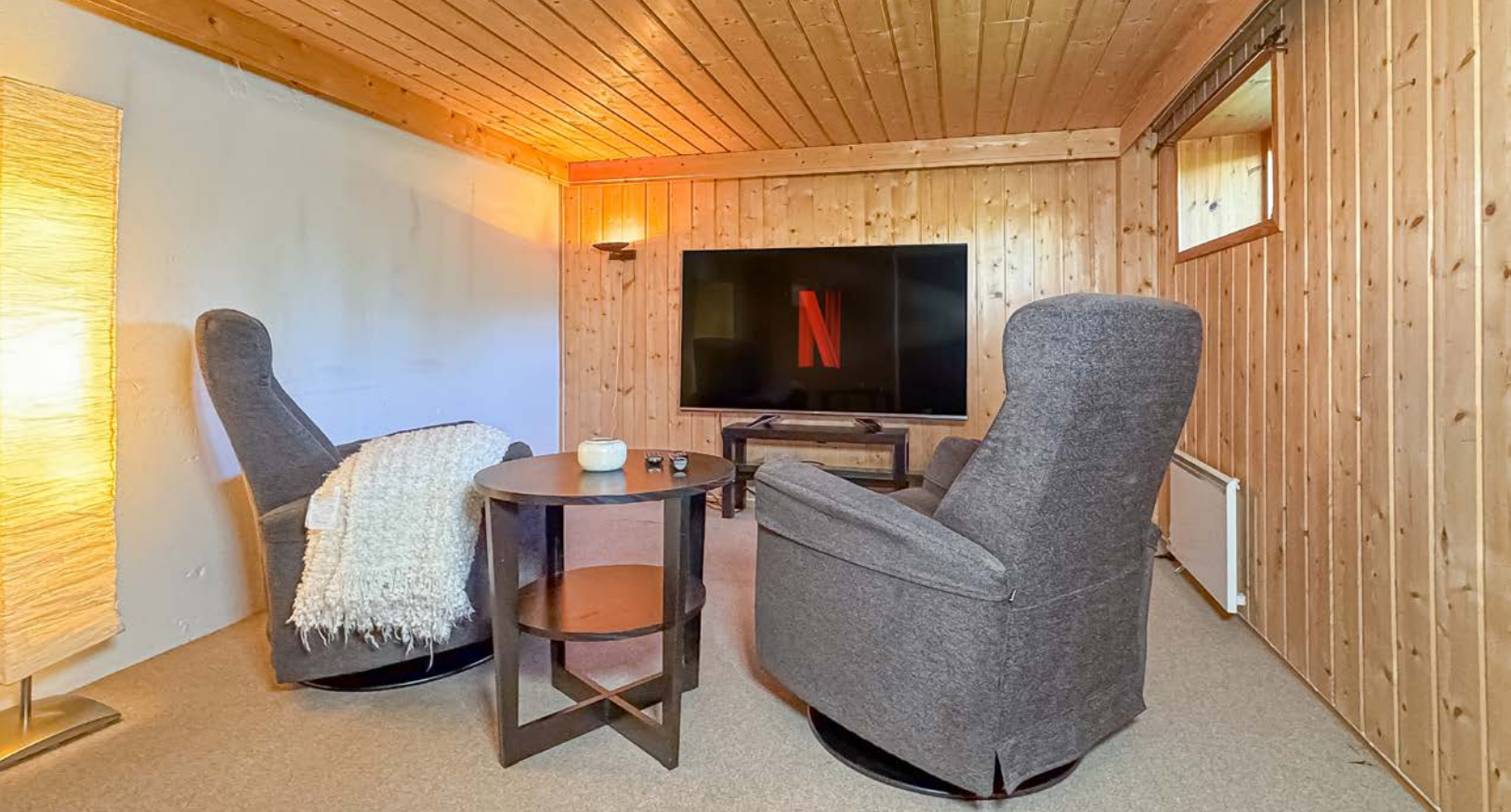
Rom i kjeller innredet som kjellerstue. Rommet er ikke søkt bruksendret og er derfor ikke godkjent til varig opphold. Vinduene er ikke store til å være godkjente som rømningsvei.
