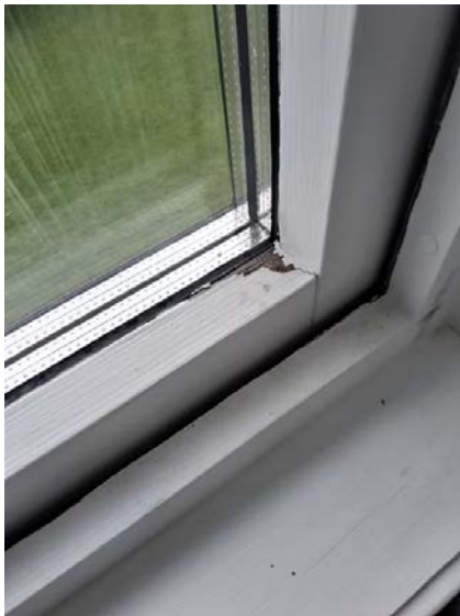
Symptomer etter kondens registreres på enkelte vinduer.
