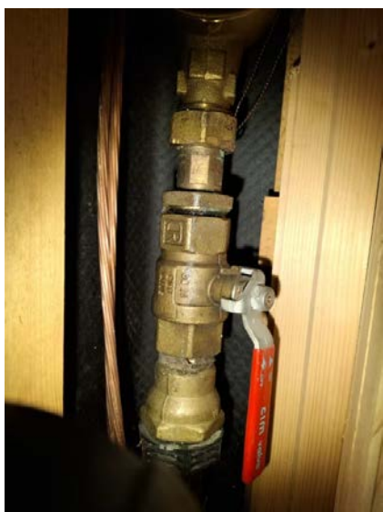
Det registreres kondens på rør ved hovedstoppekran.
