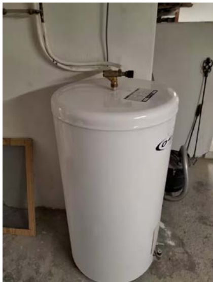
Varmtvannsbereder er plassert i kjelleretasje.
