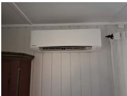
Varmepumpe er plassert i spisestue.
