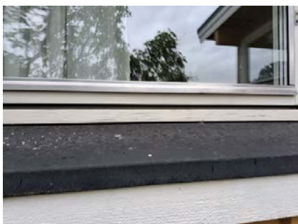
Enkelte vinduskarmer er værslitte.
