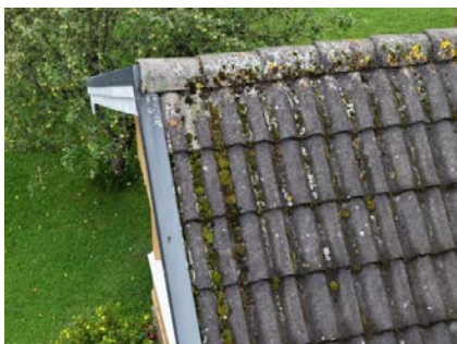
Det registreres mosevekst på taktekingen.
