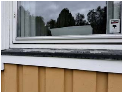
Det registreres enkelte værslitte vannbrettbeslag.
