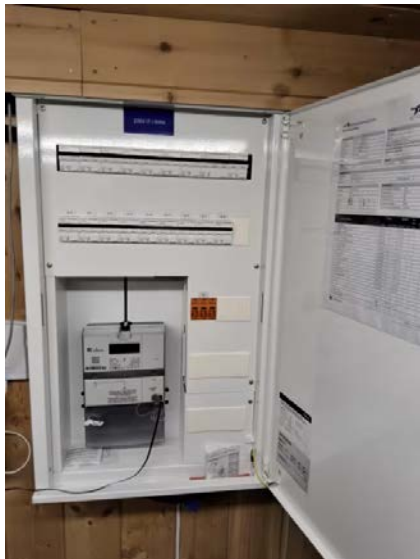
Sikringsskap er plassert i kjellerstue.
