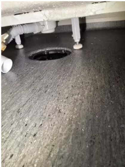
Sluk av eldre type under dusjkabinett.
