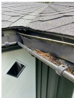
Manglende forkantbeslag og skadet treverk.
