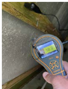
Fuktmåling i eksponert treverk på bjelkelag.
