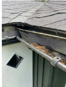
Manglende forkantbeslag og skadet treverk.
