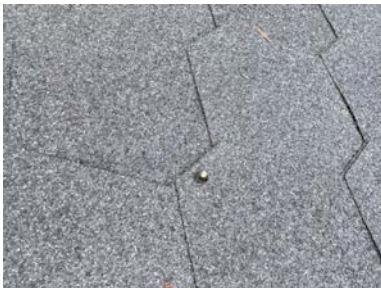
Spiker som har kommet igjennom shingel.
