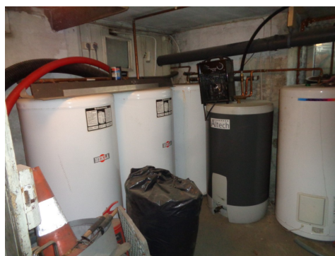
Varmtvannsberedere i kjeller.
