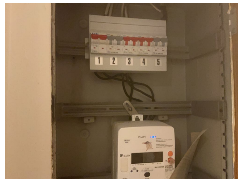
Sikringsskap i entré.
