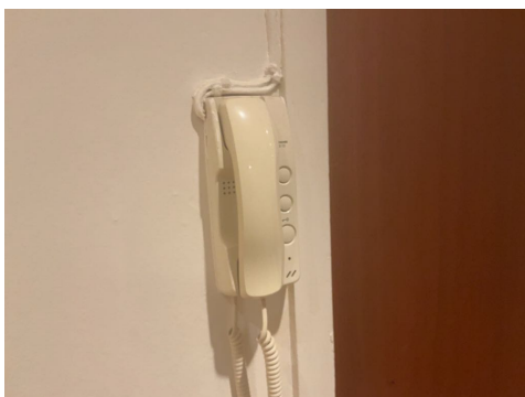
Dørtelefon i entré.
