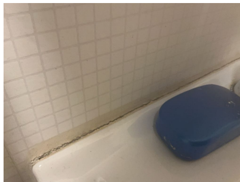
Sprekk i fuger ved servant.
