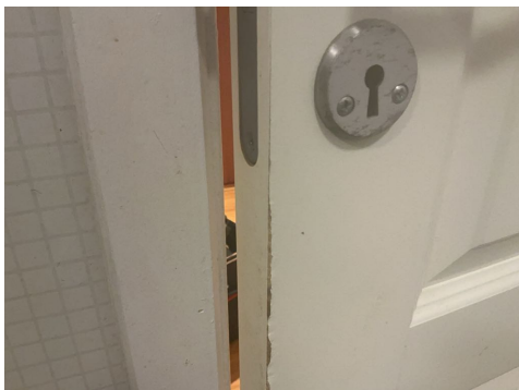
Skade på dør til badet.
