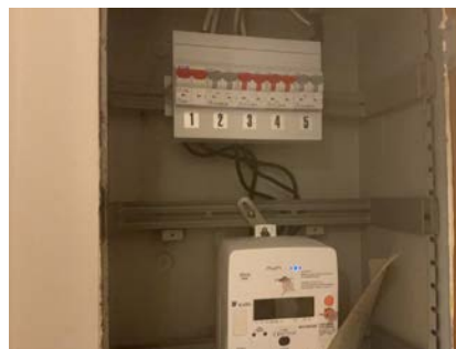
Sikringsskap i entré.
