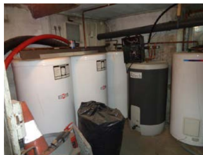
Varmtvannsbereidere i kjeller.
