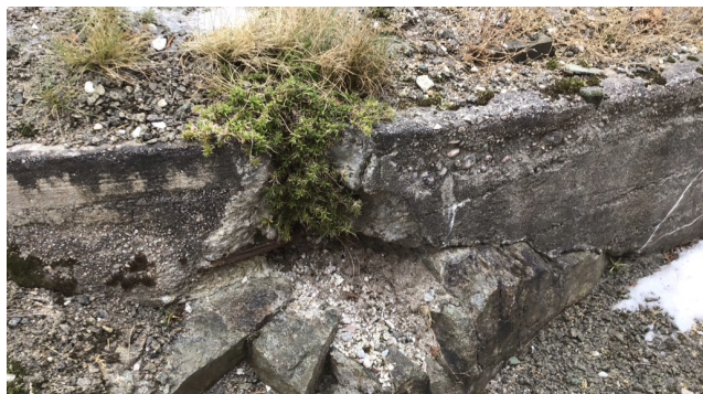
skader/sprekker i mur
