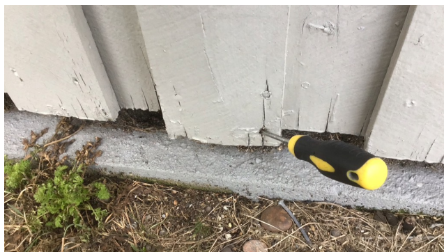
Råte i nedkant kledning
