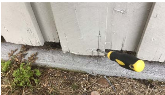
Råte i nedkant kledning
