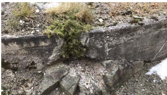
skader/sprekker i mur
