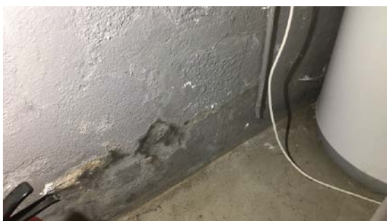
Fukt i kjellervegger i vaskerom
