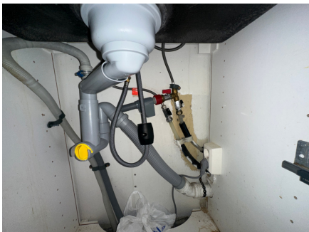
Røropplegg i kjøkkenbenk
