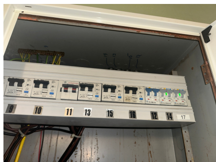
Sikringsskap plassert i felles oppgang.
