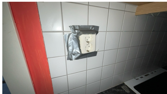
Løst stikk på kjøkken.
