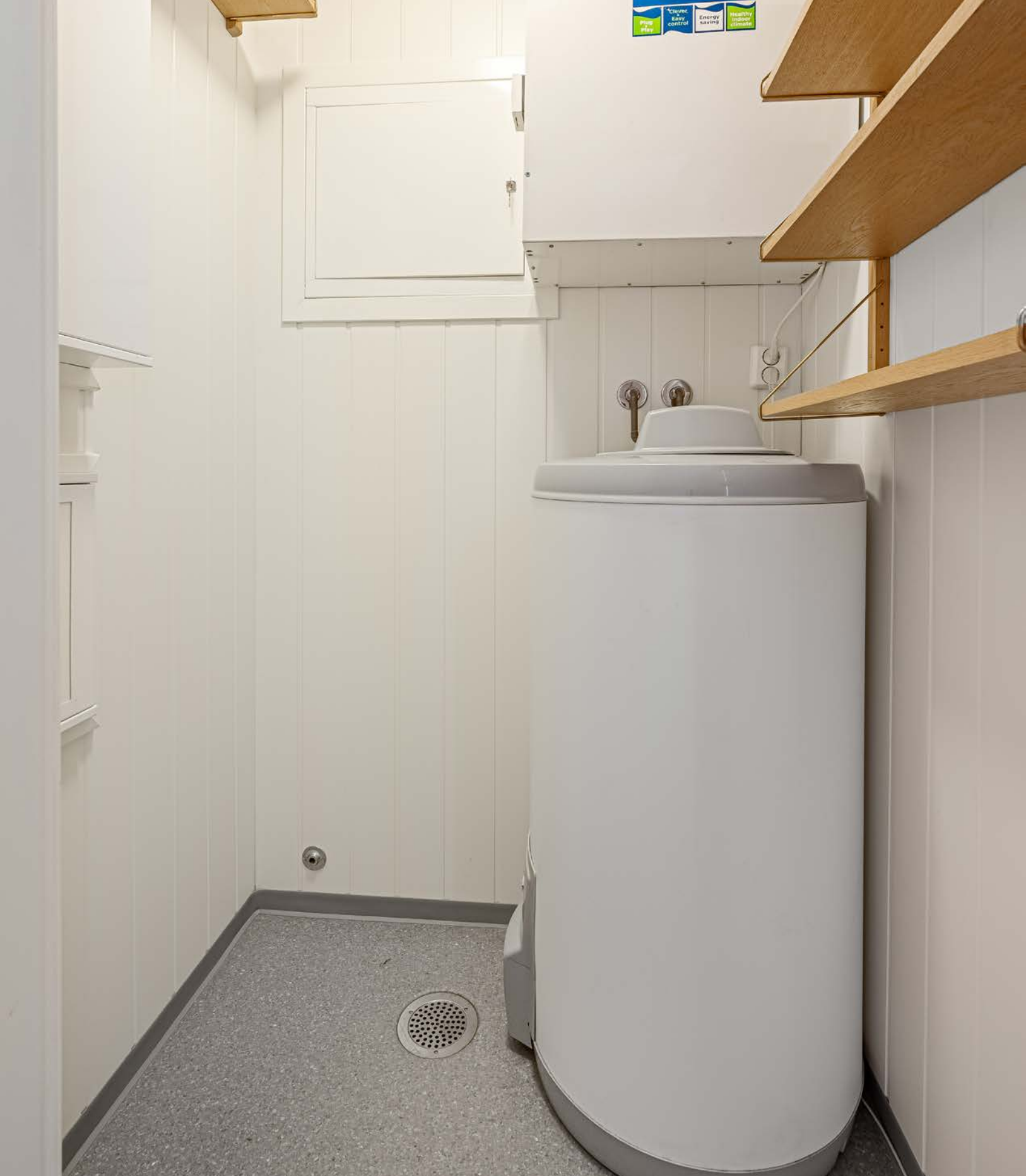
Teknisk rom inneholder sikringsskap, vannskap, varmtvannsbereder og ventilasjonsanlegg. Også her er det satt opp hyller.
