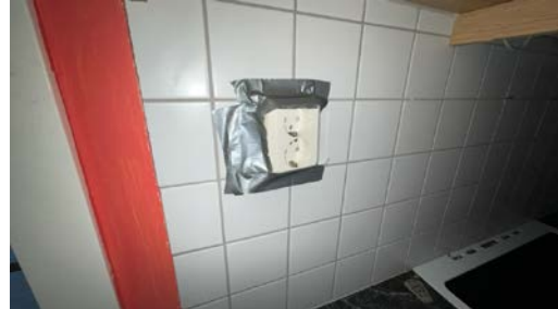
Løst stikk på kjøkken.
