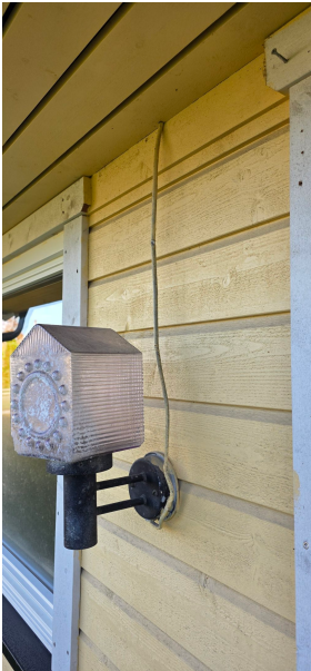
Bilde 1 Løs kabel. Bør festes.
