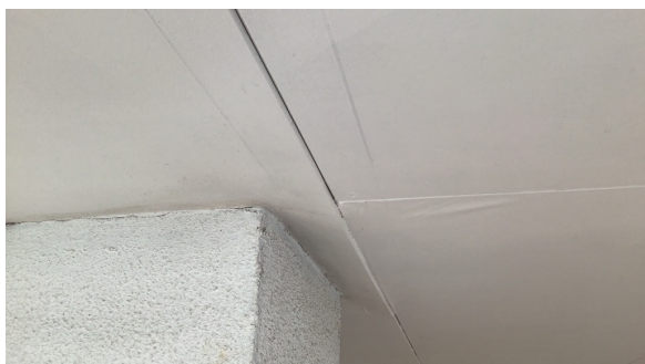
Skadet og skjev himling inntil pipe.
