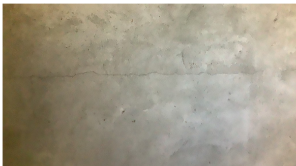
Eksempel på innvendig horisontalriss.
