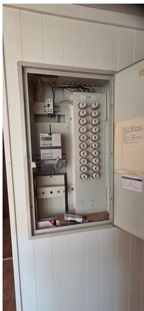
Bilde 1 Skrusikringer fra 1979
