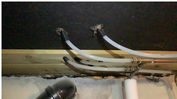
Lekkasjevann fra rør i rør system ledes til rom i kjeller uten sluk.
