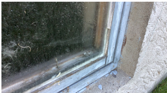
Eksempel på værslitt kjellervindu.
