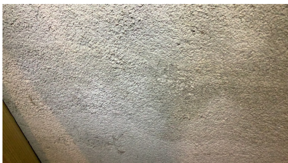
Bildet viser saltutslag på åpen murvegg.
