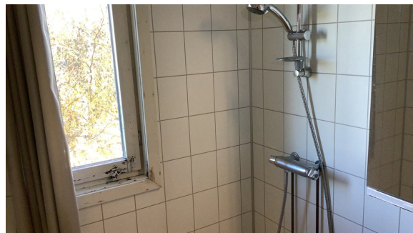
Vindu er plassert i den definerte våtsonen.
