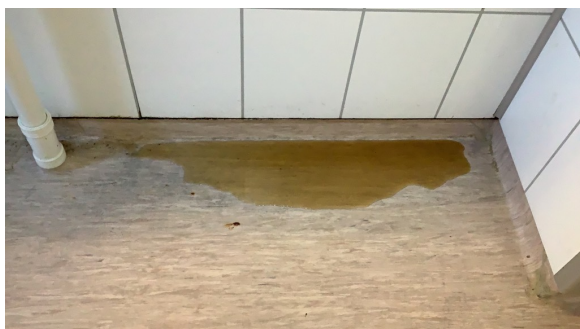
Det ligger vann i gulvet.
