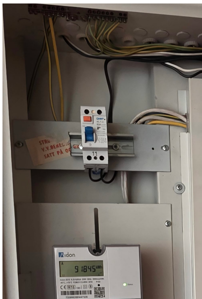
Bilde 1 Manglernkapsling på jordfeilbryter.
