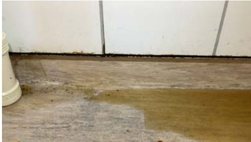
Baderomsplater med fuktskader.
