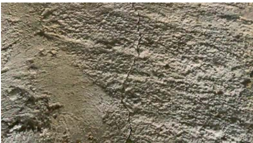
Sprekk i betonggulv.
