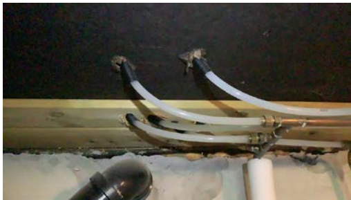
Lekkasjevann fra rør i rør system ledes til rom i kjeller uten sluk.
