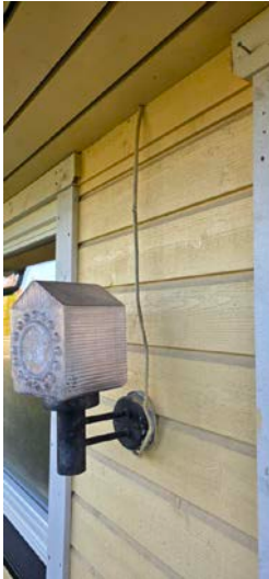
Bilde 1 Løs kabel. Bør festes.
