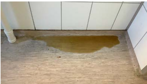
Det ligger vann i gulvet.
