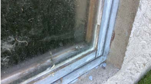
Eksempel på værslitt kjellervindu.
