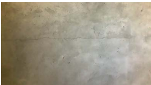
Eksempel på innvendig horisontalriss.
