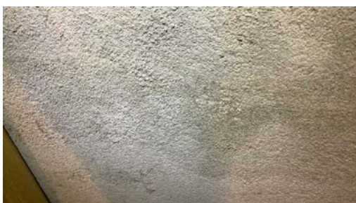
Bildet viser saltutslag på åpen murvegg.
