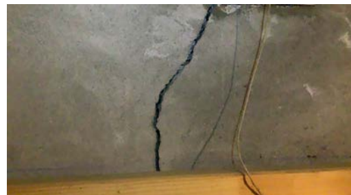
Eksempel på innvendig sprekkdannelse.
