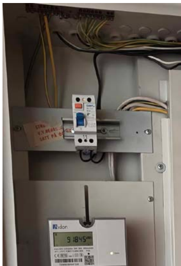
Bilde 1 Manglernkapsling på jordfeilbryter.
