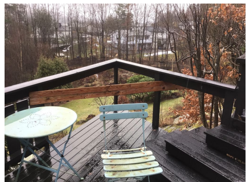
Mangler bord i rekkverk
