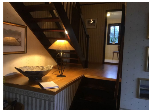
Mangler sikring/rekkverk på nivå under trapp
