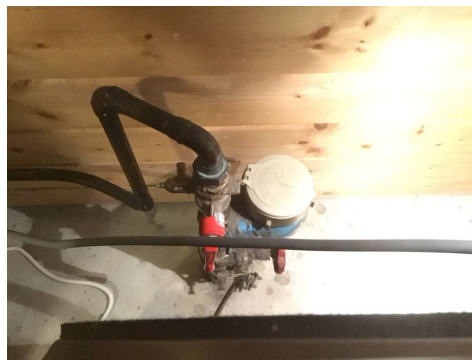
Vannmåler og stoppekran på vaskerom
