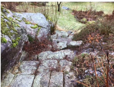
Trapp med sprekker og løse stein
