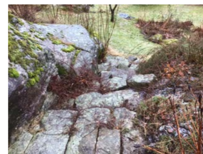
Trapp med sprekker og løse stein
