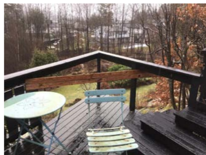
Mangler bord i rekkverk
