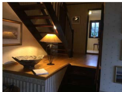
Mangler sikring/rekkverk på nivå under trapp
