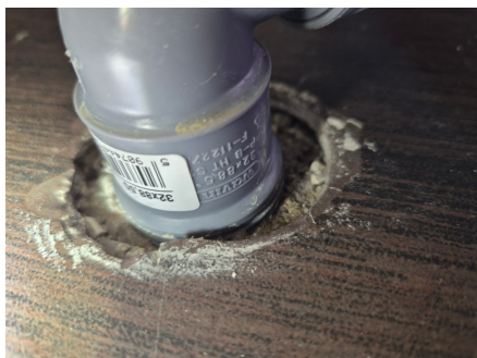
Avløp fra kabinett i rør ned i gulv.
