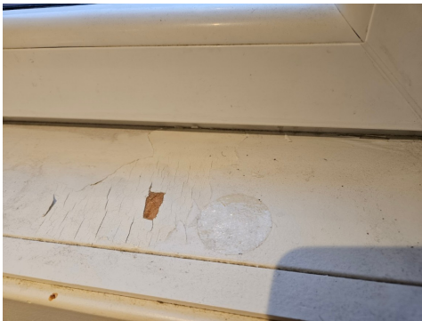
Fuktskader på utføring vindu
