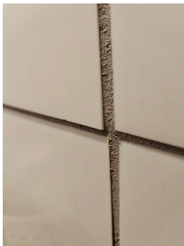
Noe ufagmessig utførelse på montering av flisarbeid
