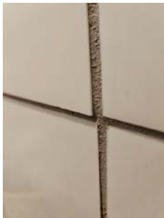
Noe ufagmessig utførelse på montering av flisarbeid
