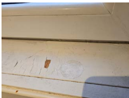
Fuktskader på utføring vindu
