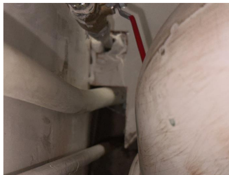
Stoppekraner plassert på bad
