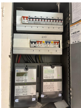
Sikringskap med automatsikringer.
