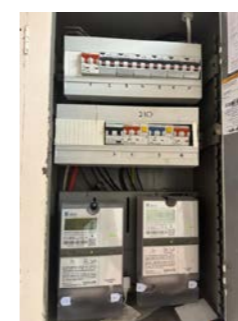
Sikringsskap med automatsikringer.
