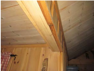
Lekkasjepunkt påvist av eier.
