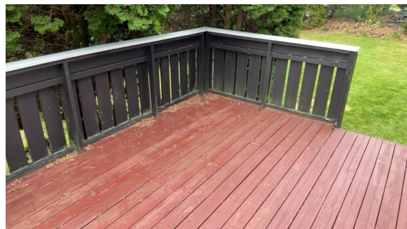
Konstruksjonene har skjevheter.
