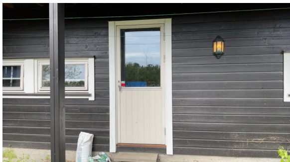
Balkongdør i kjeller fra byggeår.
