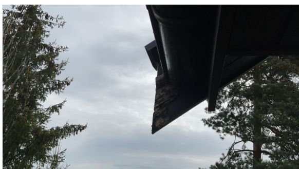
Det er registrert råteskader på vinds kier.
