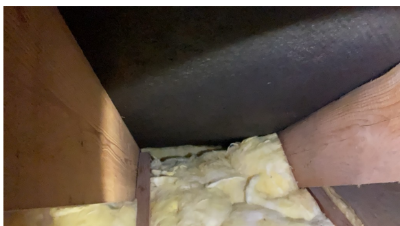
Ingen synlig lufting.
