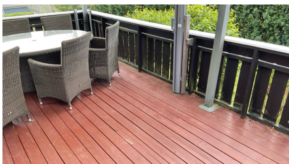
Det er etterslep på vedlikehold av overflater.
