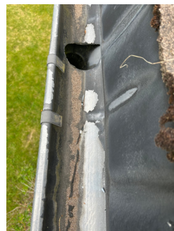
Dels påvist noe avflassing av plastbelegg på beslag.
