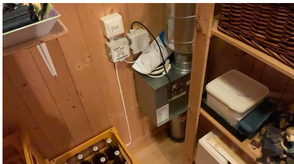
Radonvifte i kjeller. Montert 2014.
