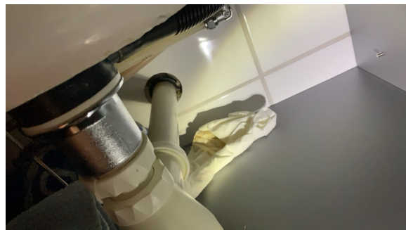
Utilfredsstillende tetting ved rørgjennomganger
