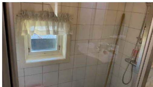
Det er vindu med ikke fuktbestandige materialer i våtsonen, løsningen eller byggematerialet er uegnet
