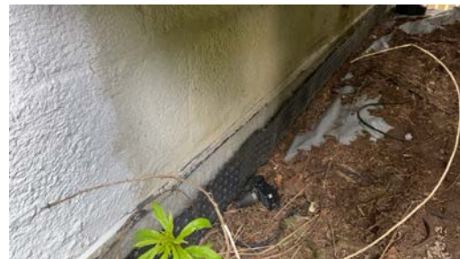
Toppliste mangler på enkelte steder.
