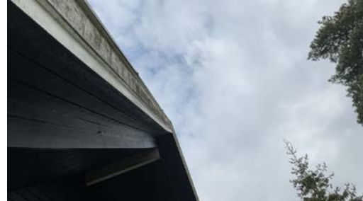
Gesimskasse har "knekk"
