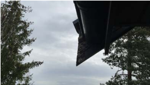
Det er registrert råteskader på vindskier.
