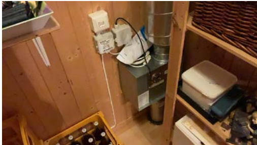
Radonvifte i kjeller. Montert 2014.
