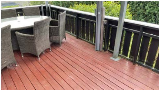
Det er etterslep på vedlikehold av overflater.
