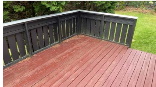
Konstruksjonene har skjevheter.
