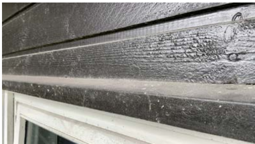
Sidebord, panel og/eller vindusomramming står i kontakt med under- og overbeslag. Dette fører til at treverket trekker opp fuktighet ved nedbør og vannavrenning.
