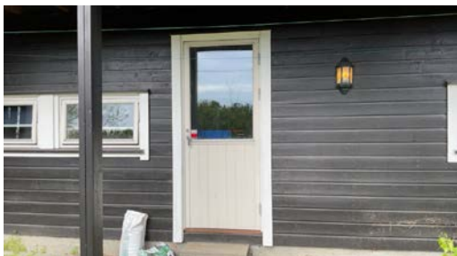
Balkongdør i kjeller fra byggeår.
