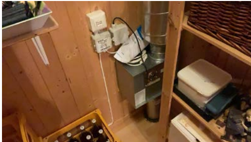
Radonvifte i kjeller. Montert 2014.
