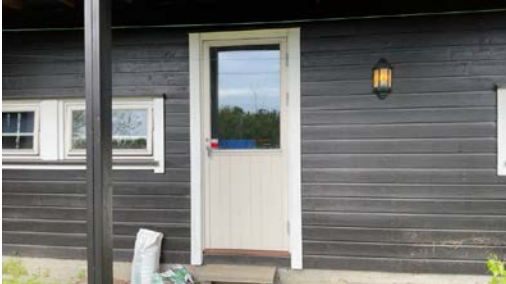
Balkongdør i kjeller fra byggeår.
