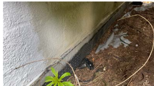
Toppliste mangler på enkelte steder.
