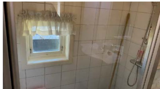
Det er vindu med ikke fuktbestandige materialer i våtsonen, løsningen eller byggematerialet er uegnet
