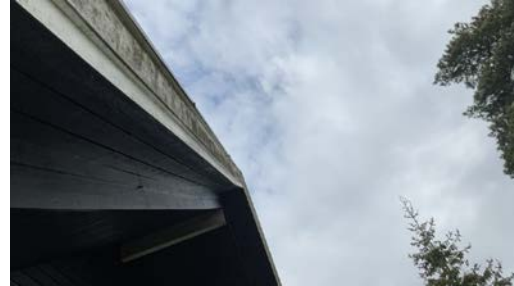
Gesimskasse har "knekk"
