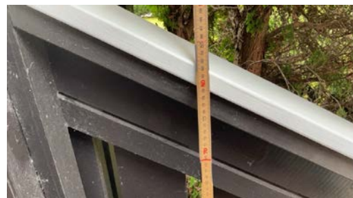
Rekkverkshøyder er under dagens forskriftskrav til rekkverk i trapper.
