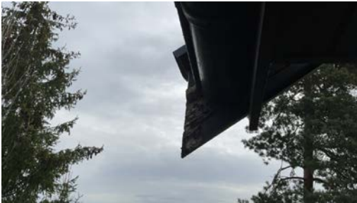
Det er registrert råteskader på vindsquier.
