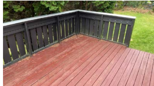
Konstruksjonene har skjevheter.
