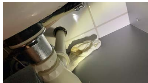
Utilfredsstillende tetting ved rørgjennomganger
