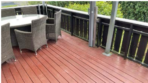
Det er etterslep på vedlikehold av overflater.
